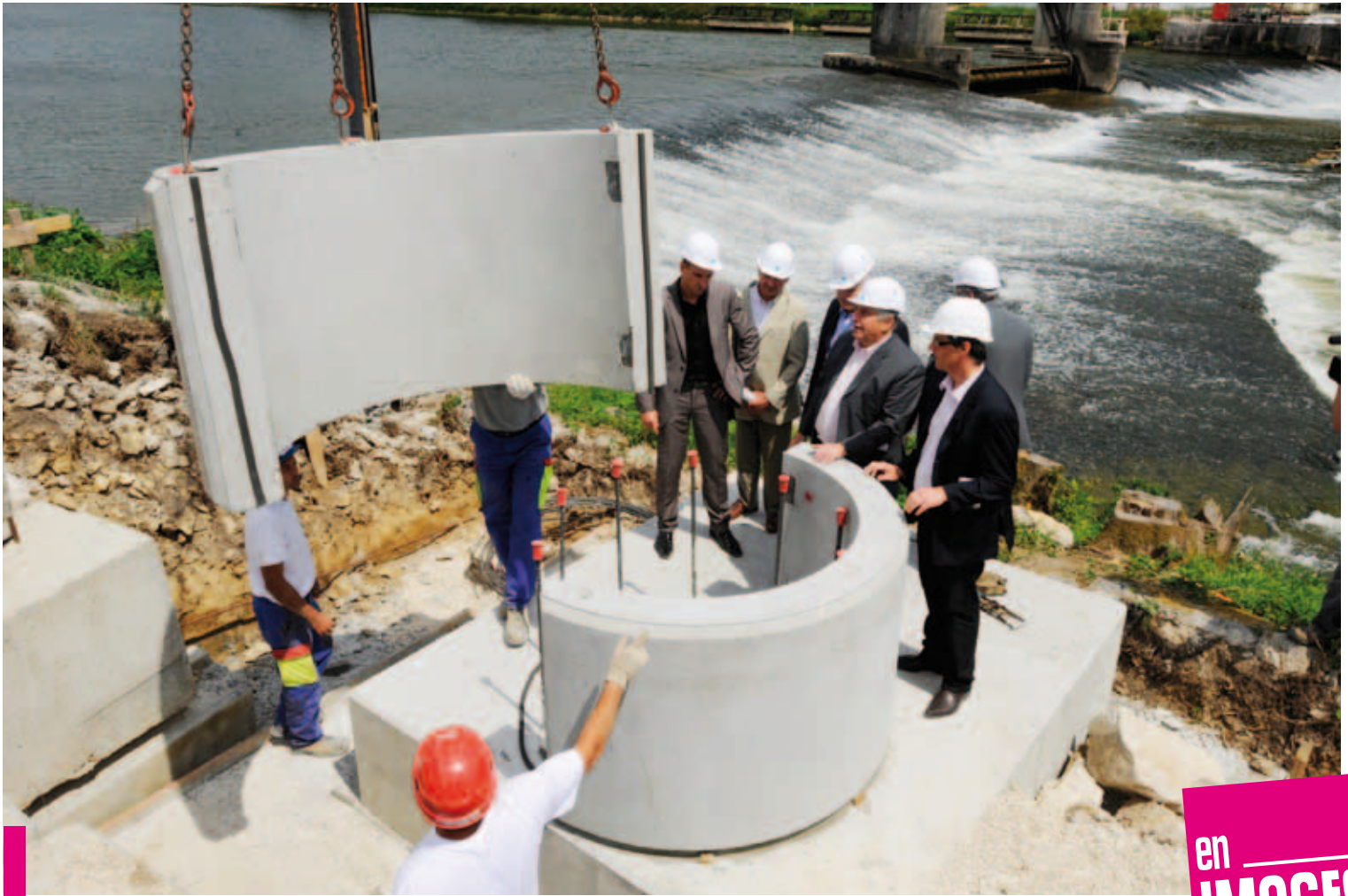
Le 23 juin, la première pierre de la passerelle de la Malate était posée.
