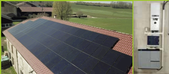
Système avec batterie de stockage
