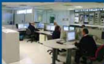
Station centrale de télésurveillance.
