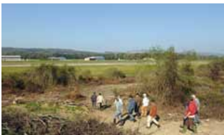
Les travaux de sécurisation de l'aérodrome de la Vèze ont été menés par des salariés en insertion.
