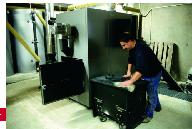
LA CHAUFFERIE BOIS REMPLACE LES DEUX ANCIENNES CHAUFFERIES À GAZ.
