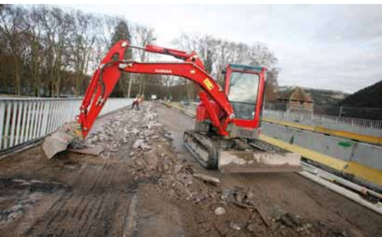
▲ CÔTÉ AMONT, LE TROTTOIR A DISPARU.
