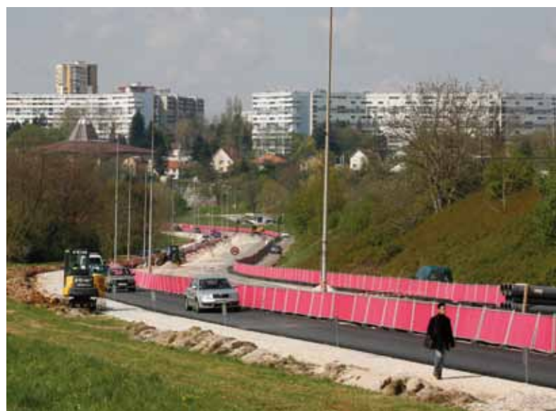
▲ UNE VOIE DE CHAQUE CÔTÉ À LA PLACE DES ANCIENNES PISTES CYCLABLES.
