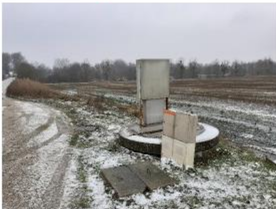
Poste de relèvement des Eaux Usées d'ETUZ
