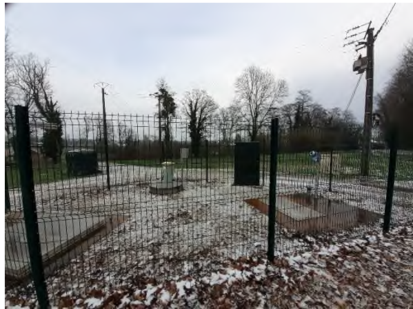
Poste de relèvement des Eaux Usées de BUSSIÈRES
