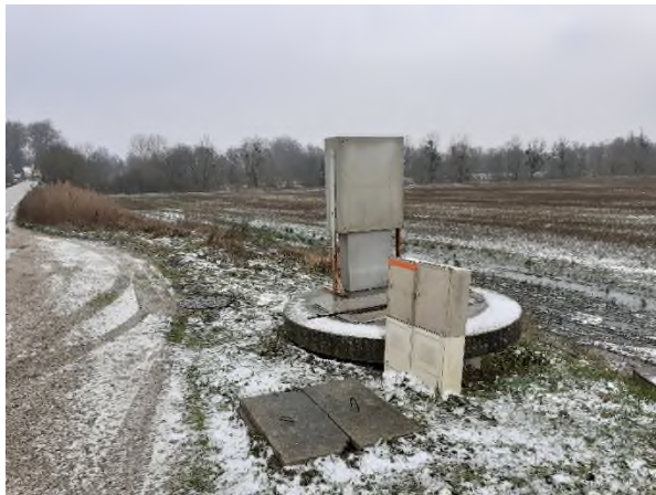
Poste de relèvement des Eaux Usées d'ETUZ
