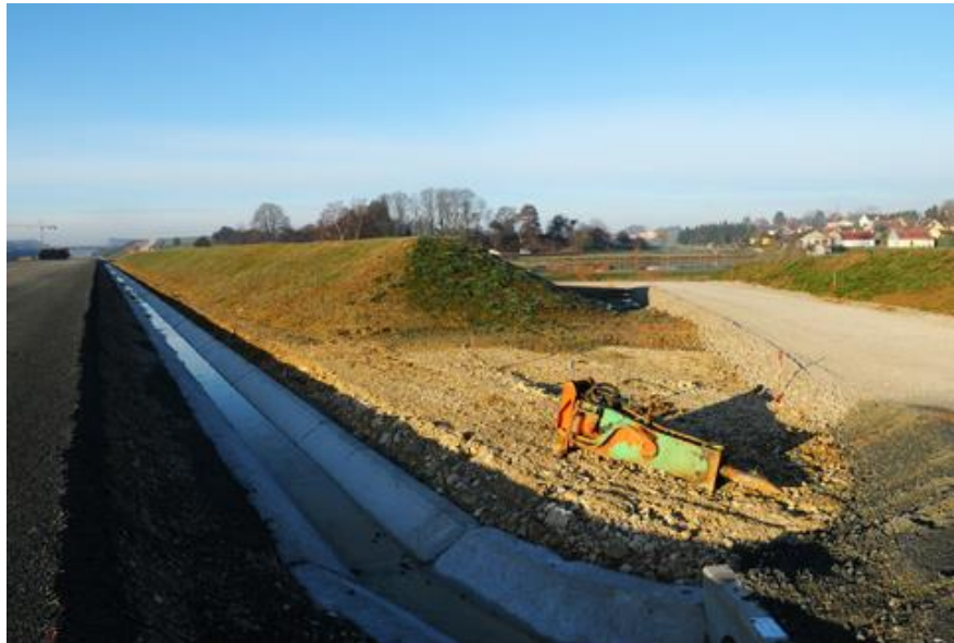
Figure 6 - Merlon de protection acoustique (source : www.lqvrhinrhone.com )
